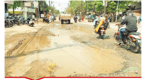
अशोक नगर सड़क की हालत जर्जर, भरा रहता है पानी, कीचड़ से होकर जाने है लोग।
